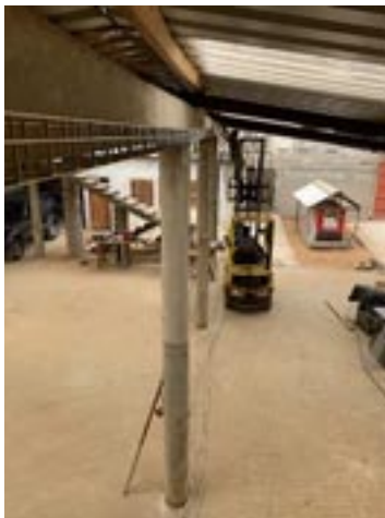
Die Kabelkanäle am Tragbalken
